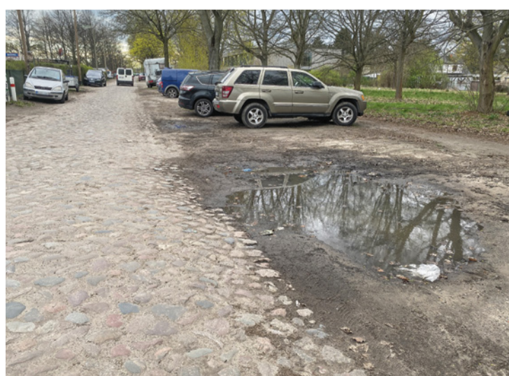
Wittenauer Straße: erfüllt nicht die Anforderungen an eine befestigte, sichere Straße Foto: Uwe Goetze
